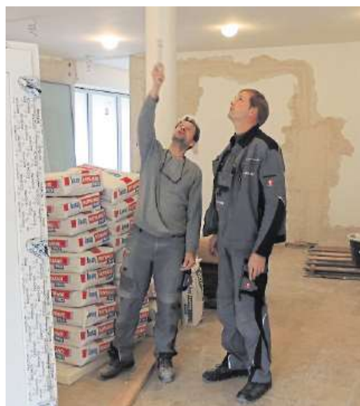
Michael Klima und Thorsten Schieferstein sind damit beschäftigt, die Elektroleitungen neu zu verlegen.
